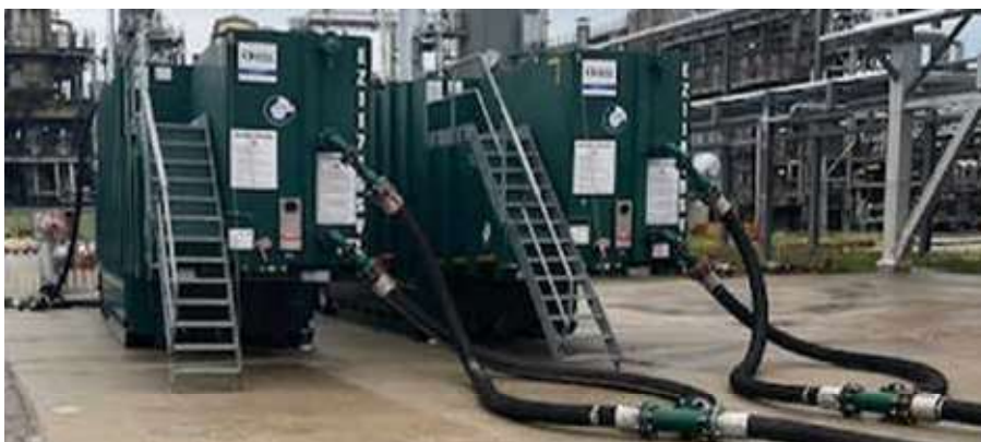
Am Rohrleitungsende wurden zwei Absetzcontainer installiert, um die gelösten Feststoffpartikel abzuscheiden.
